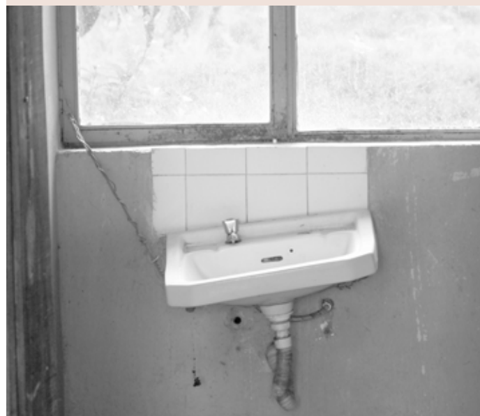
Erschreckender Zustand der Sanitäranlagen vor der Renovierung. Dieses Waschbecken wurde durch ein Seil gehalten.
